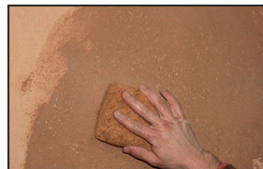
Étape 4 - une fois l'enduit sec, passage d'une éponge semi-humide afin de faire tomber les poussières de surface et faire ressortir le lin.
